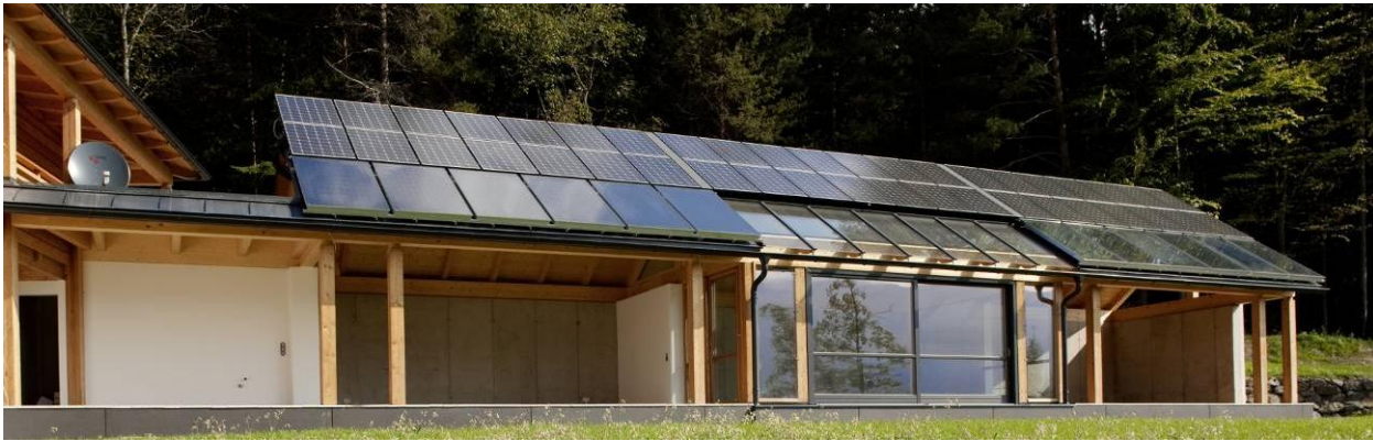
Abbildung 69: Solarthermie und Photovoltaik von Südwesten
