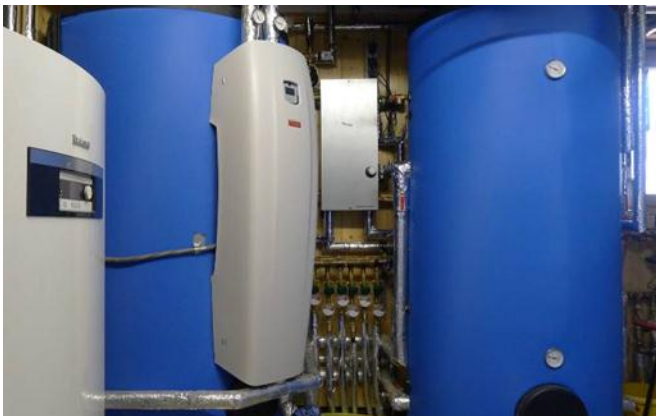
Abbildung 70: insgesamt stehen 2.500 l Speicher für Solarthermie, für Brauchwasser und Raumheizung zur Verfügung
