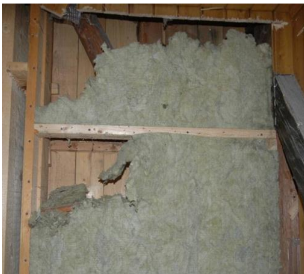
Abbildung 36: Nach dem Öffnen der alten Holzriegelwände musste zur Kenntnis genommen werden, dass ein Mader oder Sieben-schläfer große Teile der Außendämmung vernichtet hat.
