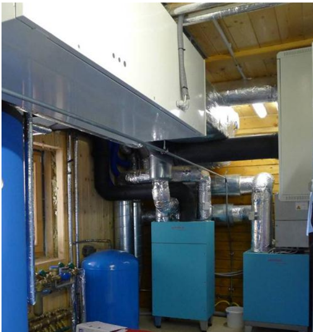
Abbildung 45: Technikraum mit den 3 Lüftungsgeräten
